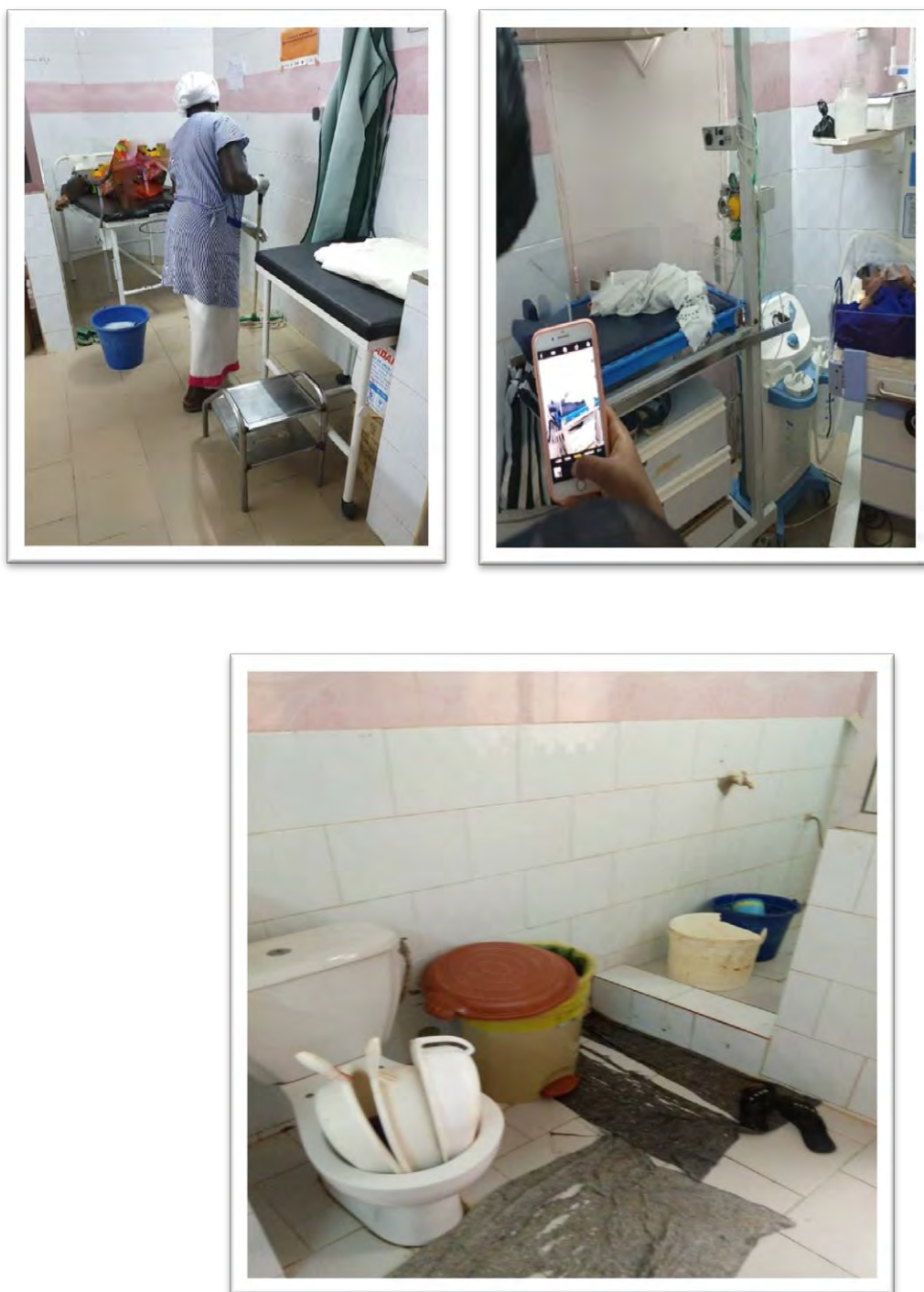
Figure 9: Coin du nouveau-né, toilette et une table d'accouchement de la maternité
